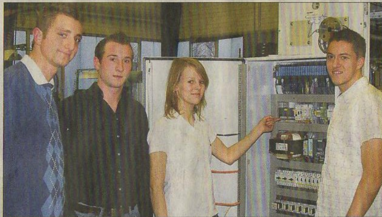
Blicken optimistisch in die Zukunft: Die Auszubildenden zum Produktionstechnologen Alexander Müller (AKG), Hans-Jochen Kalb (Fräger) und Sebastian Drebing (AKG/von links) lassen sich von ihrer Kollegin Anna Tanzer (sera) einen Schaltschrank zur Verdrahtung vom Dosieranlagen erklären.
